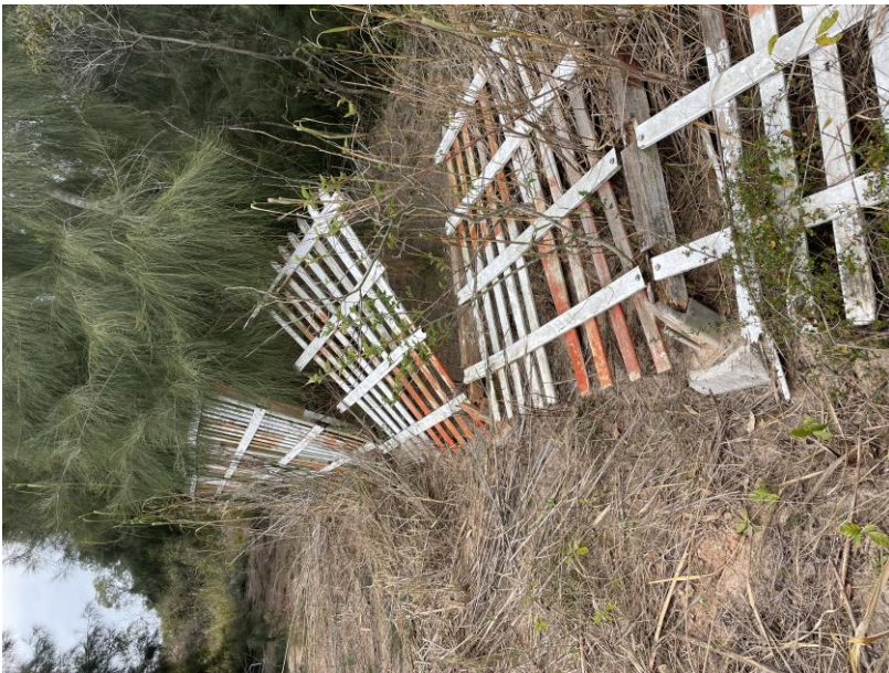
昔果山環場道旁圍籬損壞 (改善前)圖-1
