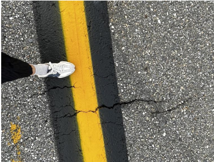
C滑行道中心線發現裂縫 (改善前)圖-1、
