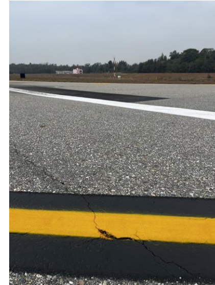
C滑行道中心線發現裂縫 (改善前)圖-2、
