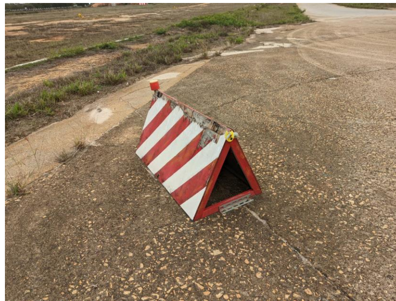
火箭連環場道兩側指示牌毀損 (改善前)圖-4
