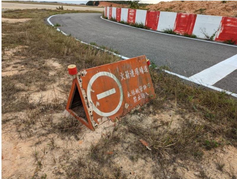
火箭連環場道兩側指示牌毀損 (改善前)圖-1、
