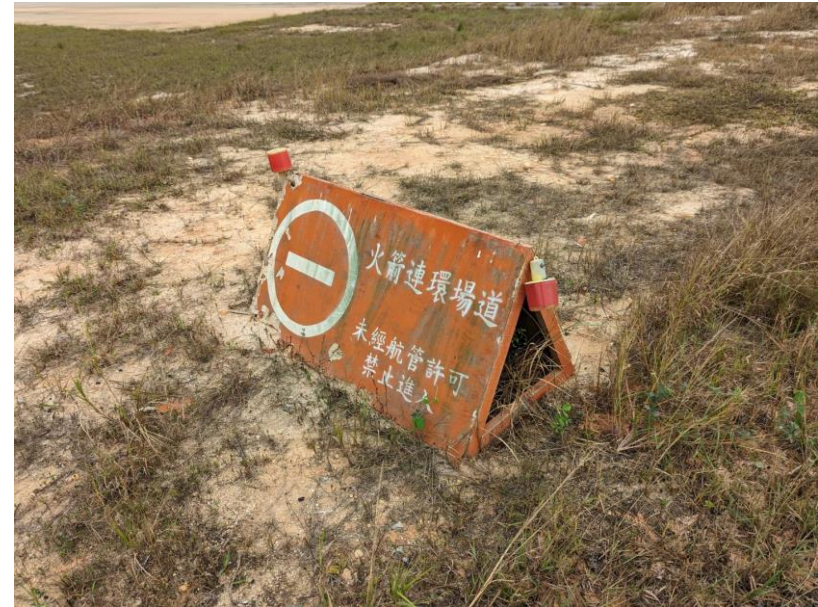
火箭連環場道兩側指示牌毀損 (改善前)圖-2、
