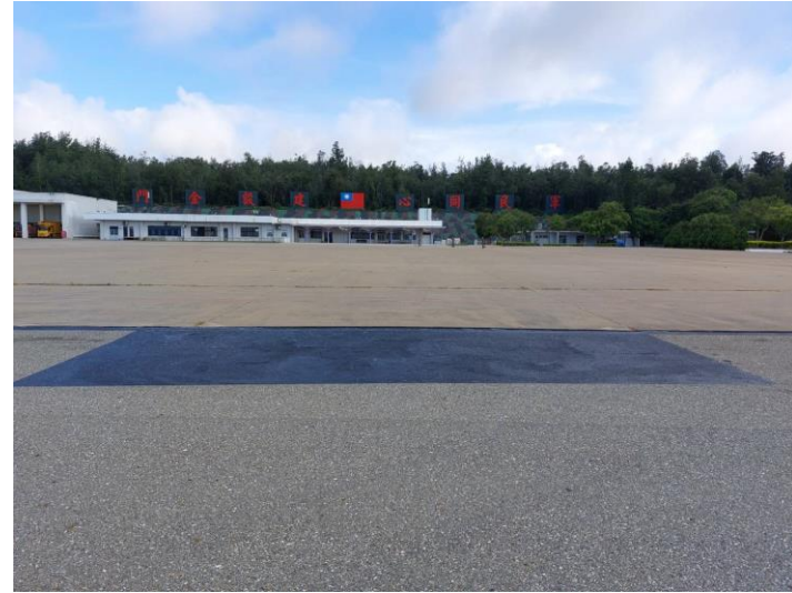
軍用停機坪前方 N 滑行道到面龜裂 7/12(改善後)圖-4
