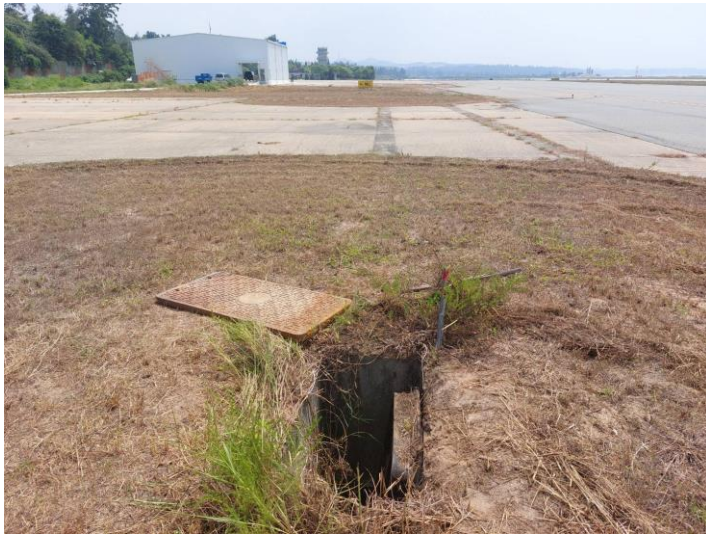
飛特立棚廠附近人孔蓋凹陷填補 (改善前)圖-1
