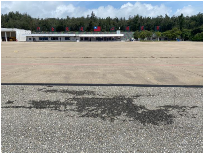
軍用停機坪前方 N 滑行道到面龜裂 (改善前)圖-1、
