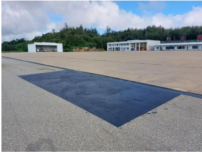
軍用停機坪前方 N 滑行道到面龜裂 7/12(改善後)圖-3、
