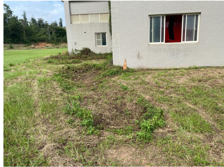
新待命點建築旁凹坑填補 (改善前)圖-10
