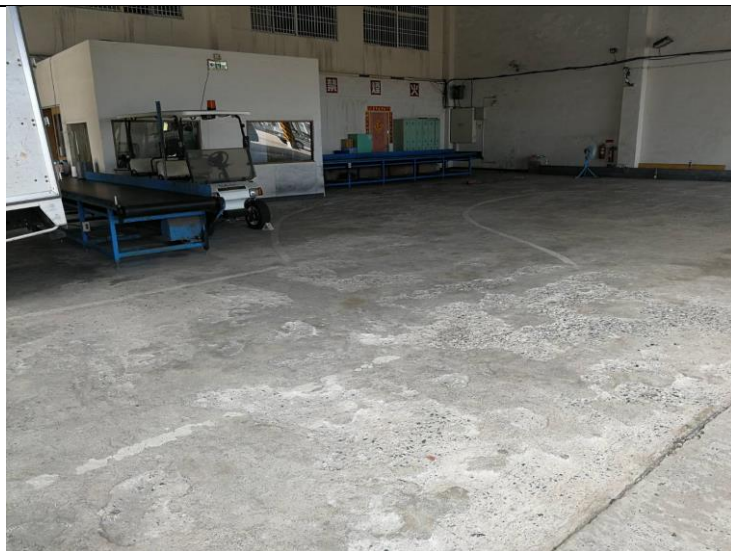
KNH-2019-0048、圖-1 小三通直掛作業區地面部分水泥表層 損壞剝離(修復前)
