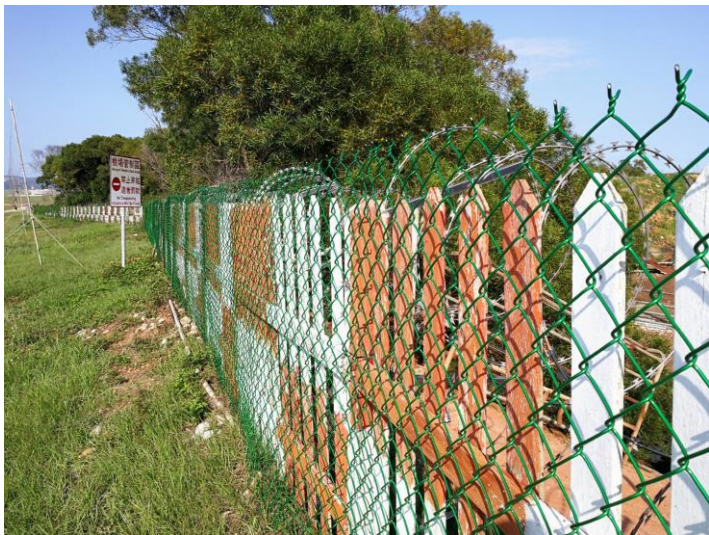
KNH-2019-0042、圖-9 后湖圍籬加強工程完成(4/10 改善後)
