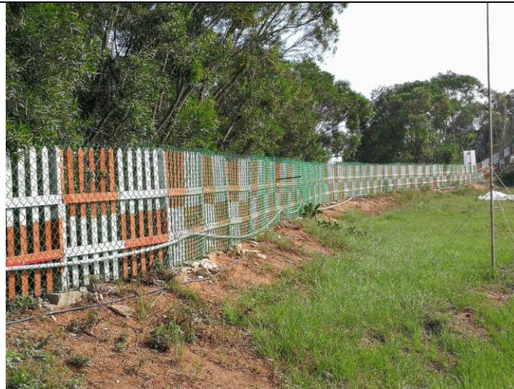
KNH-2019-0042、圖-10 后湖圍籬加強工程完成(4/10 改善後)
