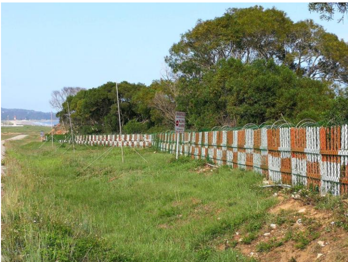
KNH-2019-0042、圖-11 后湖圍籬加強工程完成(4/10 改善後)
