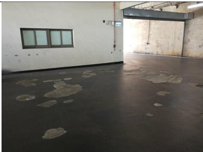
KNH-2019-0041、圖-1 離站行李處理區地 EXPOXY 剝落損壞
