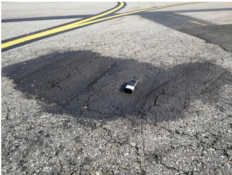
圖 2018-0013-2、N 滑行道及 B 滑行道交岔口道面破損
