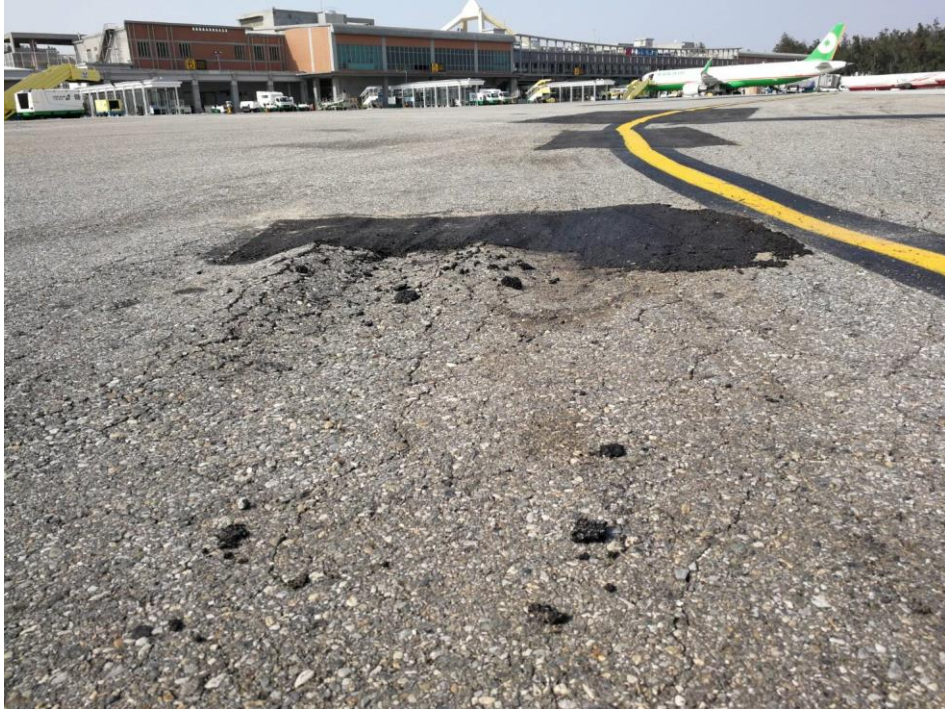
圖 2018-0013-1、N 滑行道及 B 滑行道交岔口道面破損
