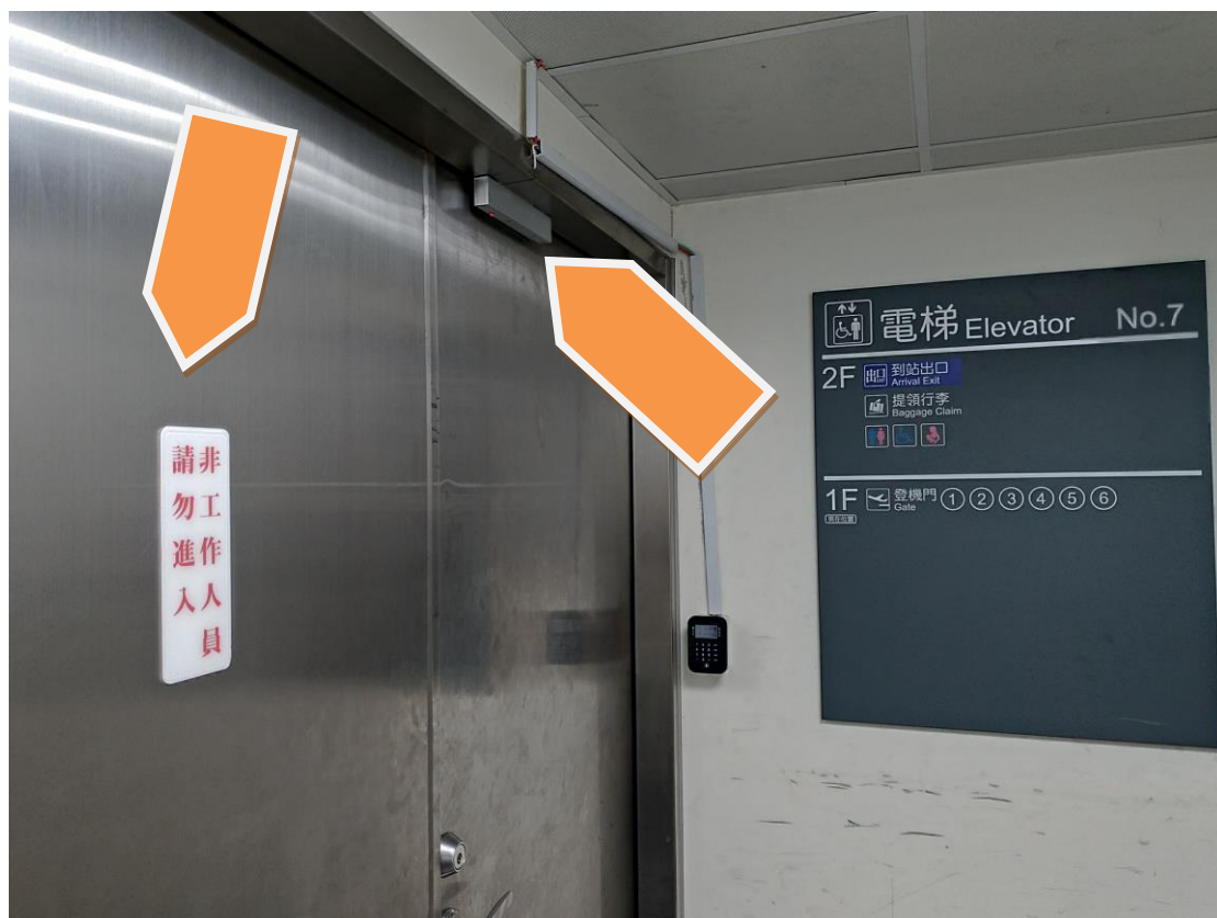
圖 2018-0001-2、完成設置警告標語牌及磁控鎖
