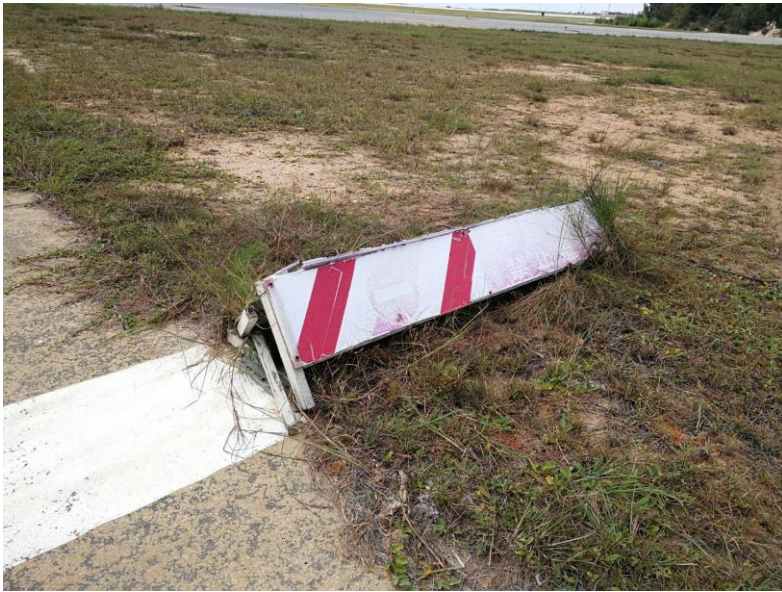
新待命點飛航管制區-警告指示牌毀損故障(改善前)圖-1
