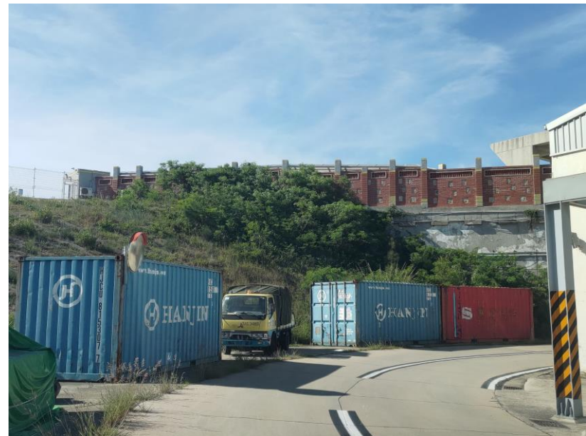
2 號管制門旁樹叢過茂建議檢修(改善前)圖-2、
