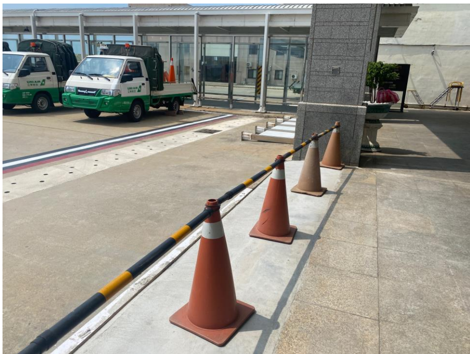
風雨走廊護欄及附近地磚水泥損毀(改善前)圖-3
