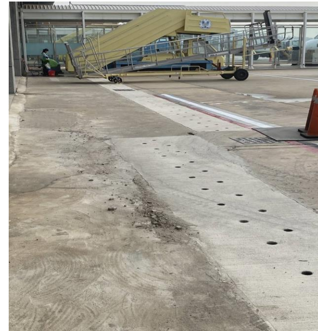
3 號-6 號停機坪登機廊道與停機坪 PC 鋪面交界處(改善前)圖-2
