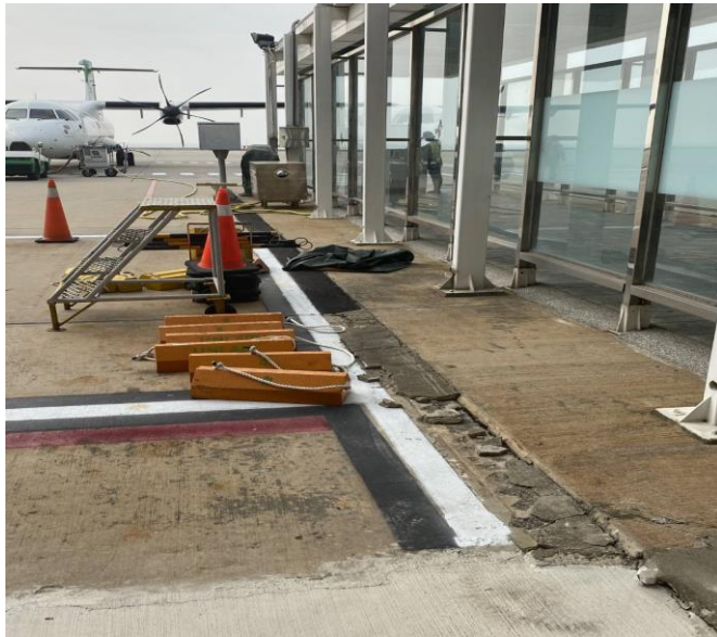
3 號-6 號停機坪登機廊道與停機坪 PC 鋪面交界處(改善前)圖-1、
